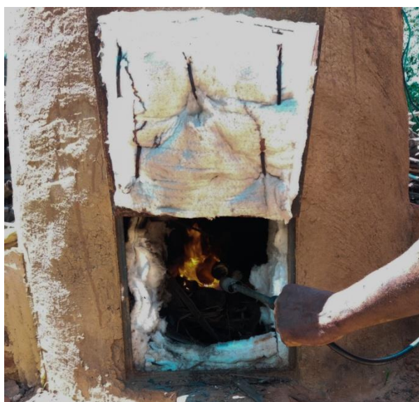
Figura 4 – Acendimento da fornalha.
