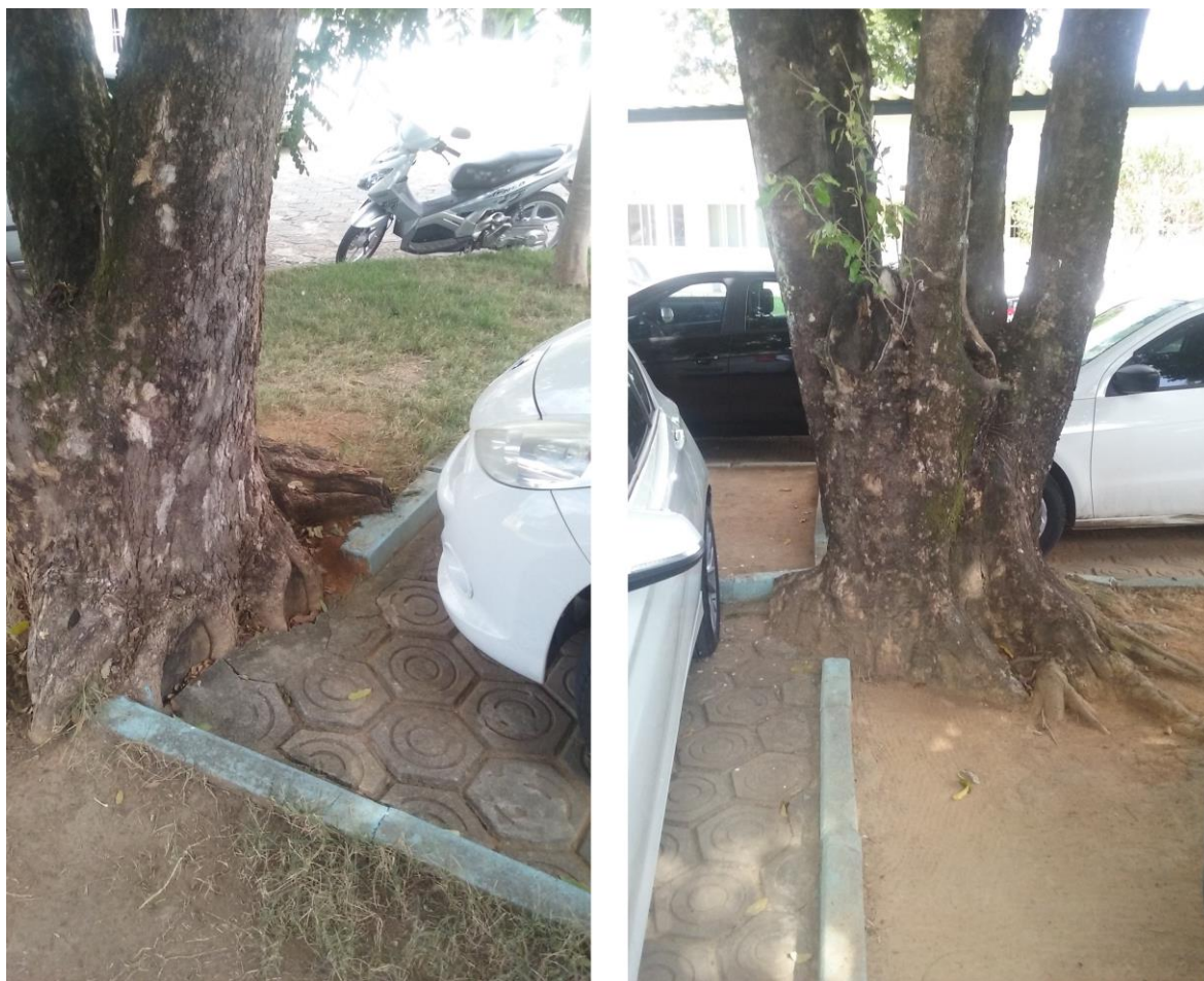
Figura 14 - Licania tomentosa em conflito com a pavimentação, no setor de estacionamento da UFES Campus Alegre, Alegre – ES.
